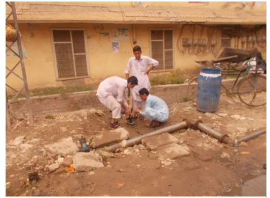
Jóvenes aprovechan el agua de una tubería con fugas en la ciudad paquistaní de Peshawar.
