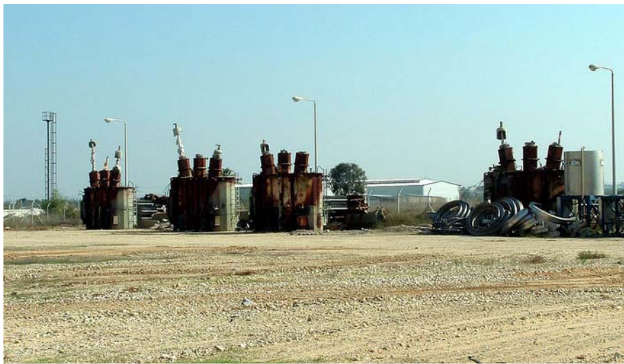
Las plantas de generación eléctrica de Gaza siguen dañadas tras el bombardeo israelí de 2006.
