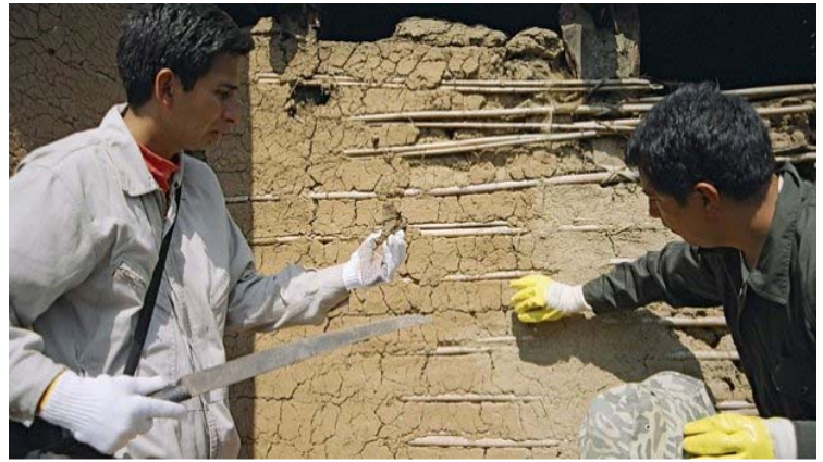
La vinchuca vive en las grietas de paredes y techos de viviendas de adobe, ramas, paja, etc.
