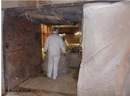
Edificio contaminado con amianto en Alemania.
